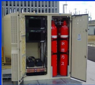
E-2500 2台による 5kWシステム設置例
